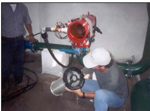
Revisión de filtros
